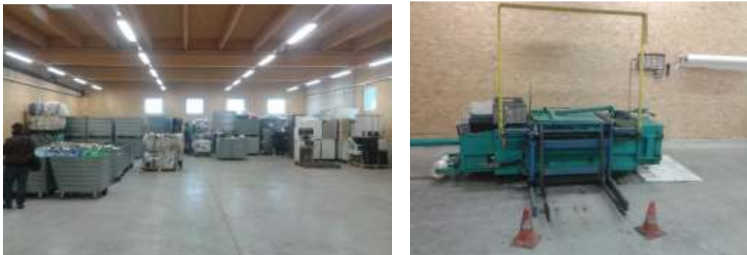
Εικόνα 17: Χώρος αποθήκευσης – συμπίεσης μικρών ανακυκλώσιμων αποβλήτων
