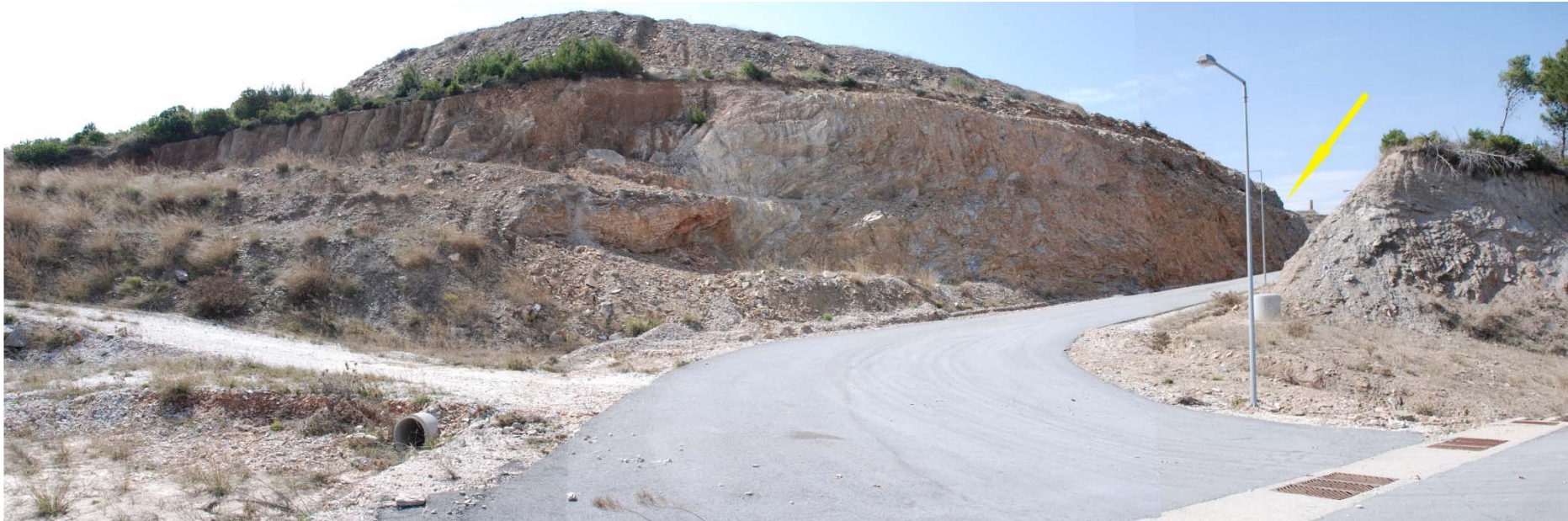
Φωτογραφία 4-3. Αποψη του νοτίου σκέλους αμφίπλευρου ορύγματος του εσωτερικού οδικού δικτύου που διαμορφώνεται ΒΑ/ικά και κατάντη της πλατείας του συνεργείου. Σημειώνεται με βέλος αναβαθμίδα της οποίας προτείνεται η συνέχεια και στο τμήμα που εξετάζεται.
