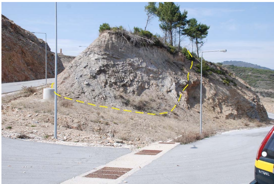
Φωτογραφία 4-7. Αποψη της προεξοχής που δημιουργείται από τη συμβολή τεχνητών πρανών κλάδων του εσωτερικού οδικού δικτύου. Σημειώνεται το περίγραμμα της προτεινόμενης ελάφρυνσης.
